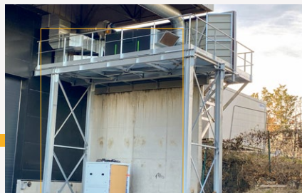
SIGMA Clermont Système de ventilation et de chauffage (mécanique)
